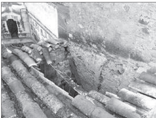
El tros de teulada enfonsat està just a sobre la portalada d'entrada a la Doma
