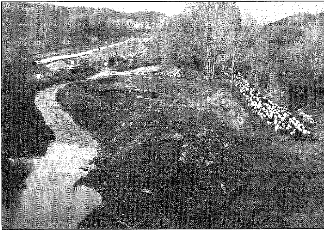
La instal·lació de les canonades d'ATLL està malmetent la llera de la Tordera (Plataforma per a la Salvaguarda del Montseny)
